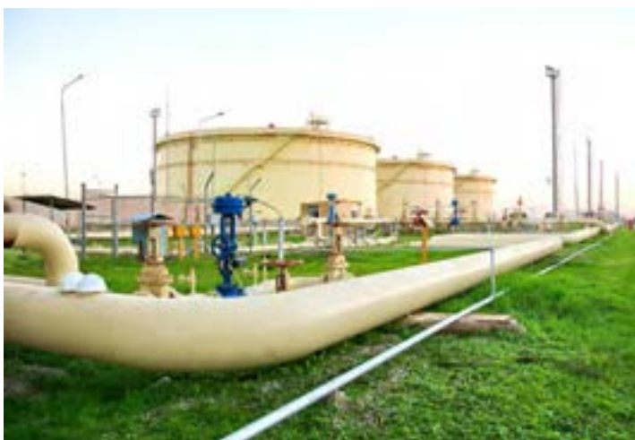
شکل ۲۰- نمایی از خطوط انتقال سوخت
