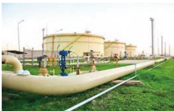
شکل ۲۰- نمایی از خطوط انتقال سوخت
