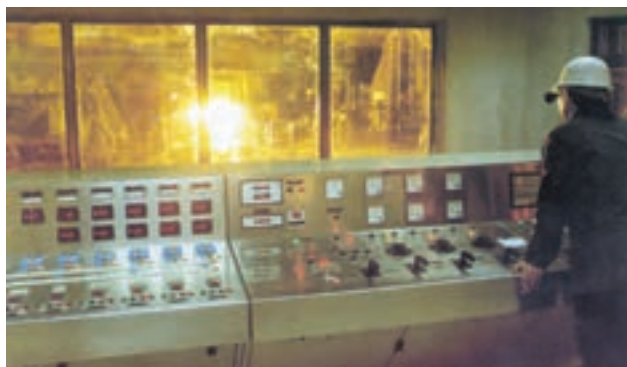
اتاق کنترل نیروگاه برق
